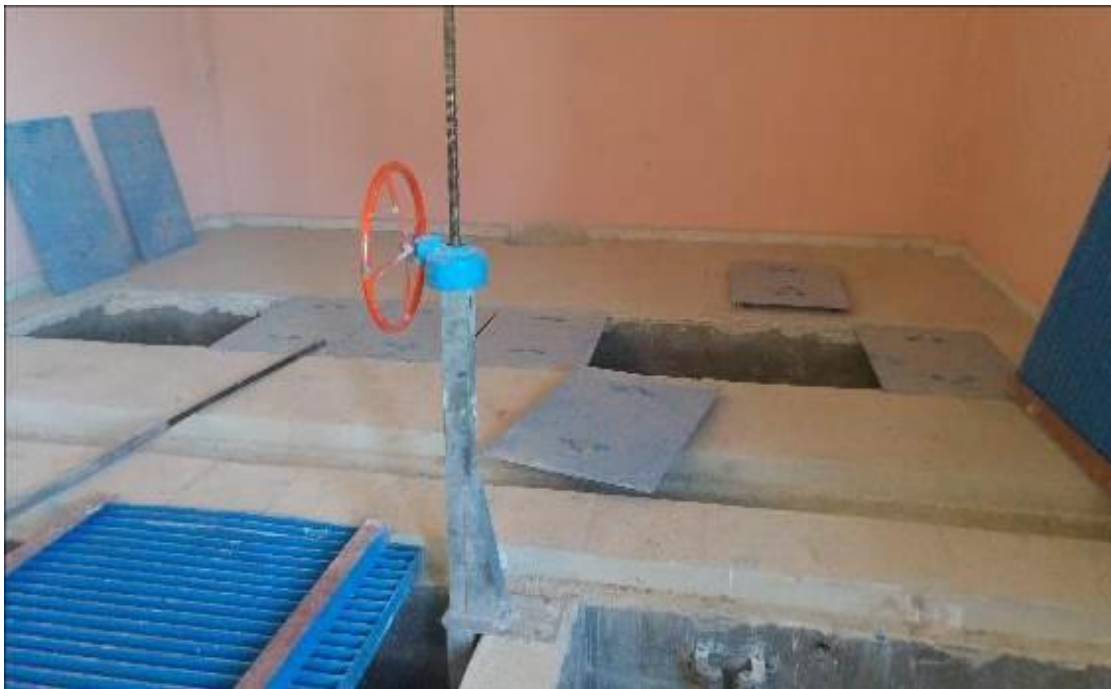
FOTO 9: Instalaciones internas del sistema de bombeo en la Planta de Tratamiento de Aguas Residuales Luyanó IV, Cuba, noviembre de 2016.
