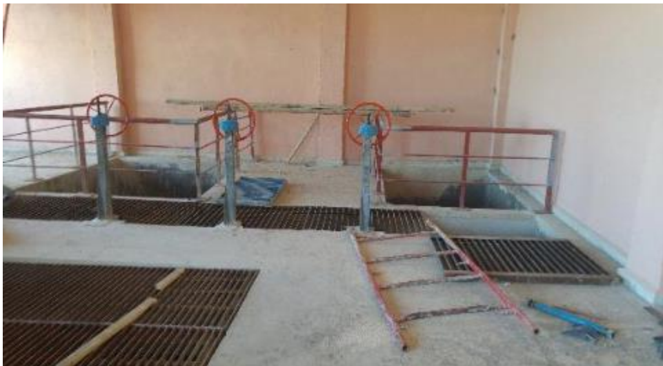
FOTO 7: Instalaciones internas en la casa de estación de bombeo en la Planta de Tratamiento de Aguas Residuales Luyanó IV, Cuba noviembre de 2016.
