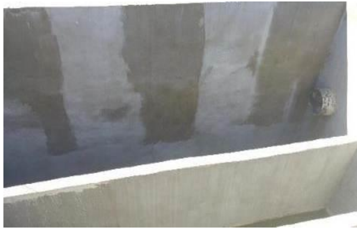
FOTO 5: Tanque de Contacto para la Cloración en la Planta de Tratamiento de Aguas Residuales Luyanó IV, Cuba noviembre de 2016.
