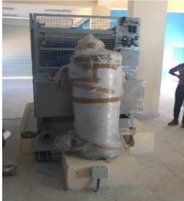
FOTO 13: Compactador paara el Secado de Lodos en la Planta de Tratamiento de Aguas Residuales Luyanó IV, Cuba noviembre de 2016.
