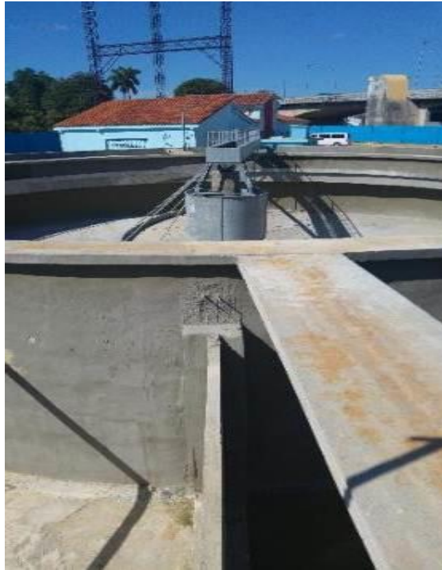
FOTO 19: Cámara de Aireación y Ssedimentador Secundario en la Planta de Tratamiento de Aguas Residuales Luyanó IV, Cuba noviembre de 2016.
