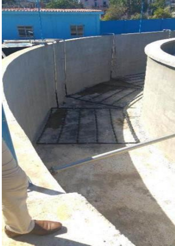
FOTO 21: Instalaciones internas para la Aireación en los Reactores en la Planta de Tratamiento de Aguas Residuales, Luyanó IV, noviembre de 2016.
