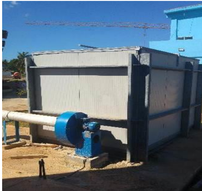
FOTO 10: Biofiltro de la Estación de Bombeo Principal en la Planta de Tratamiento de Aguas Residuales Luyanó IV, Cuba noviembre 2016.
