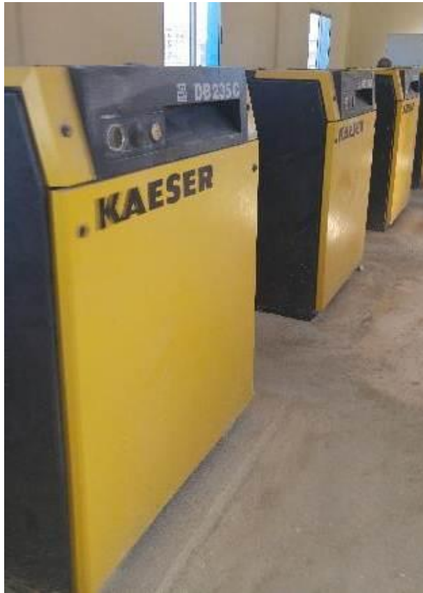
FOTO 20: Cámara de compresores para el sistema de aereación en la Planta de Tratamiento de Aguas Residuales Luyanó IV, Cuba, noviembre de 2016.
