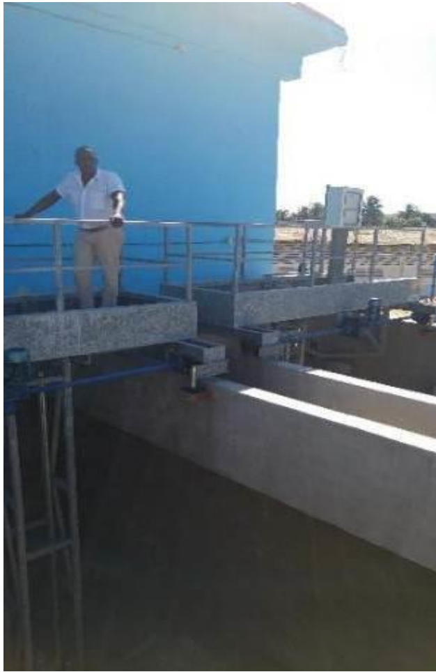
FOTO 18: Desarenador y desengrasador en la Planta de Tratamiento de Aguas Residuales Luyanó IV, Cuba noviembre de 2016.
