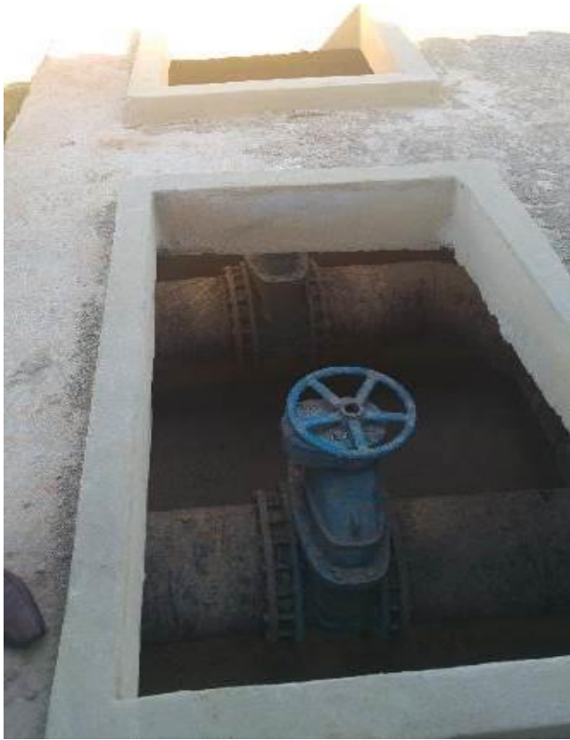
FOTO 11: Válvula de control hacia Pre Tratamiento de la Planta de Tratamiento de Aguas Residuales Luyanó IV, Cuba, noviembre de 2016.
