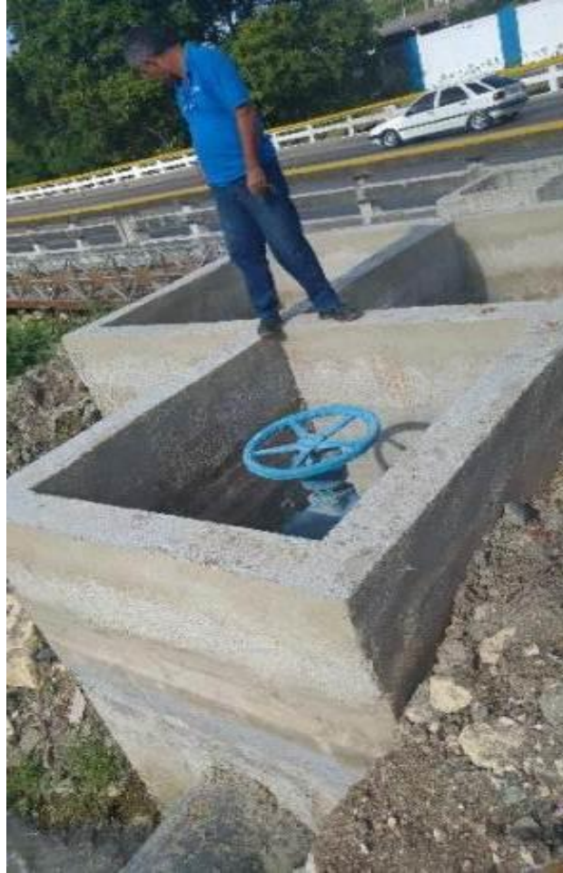
FOTO 28: Caja de distribución y by-pass de aguas residuales previo a la entrada en la PTR Luyanó IV, Cuba, noviembre de 2016.
