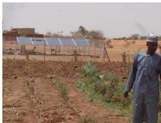
Photo N° 2 : Site maraîcher de goutte à goutte du village d'Adalak/Département de Dakoro avec une installation d'énergie solaire
