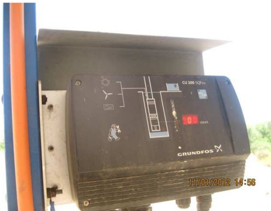
Regulador del sistema de bombeo GRUNDFOSS
