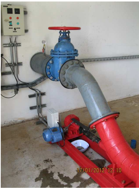
Tubería de carga, válvula y regulador
