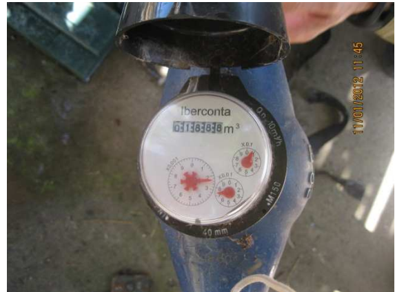
Contador de agua bombeada (acumulado 1888 m3, promedio 1.7 m3/día durante 3 años)
