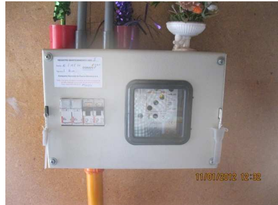
Caja con Regulador de carga (Phocus) (derecha centro), y breaker (izquierda centro). Adhesivo de revisión de sistema por empresa Conafe. Batería de 150 Ah de gel de descarga profunda, montada sobre base metálica.
