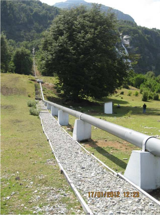
Tubería de carga y caída de agua al fondo
