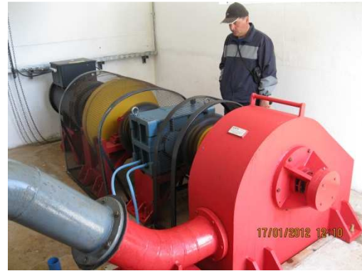
Turbina, multiplicador y generador
