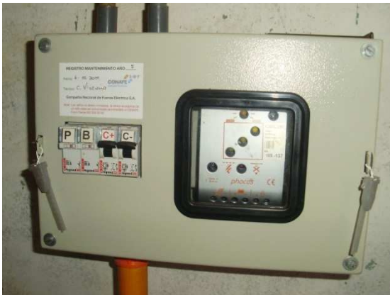
Caja con Regulador de carga (Phocus) (derecha centro), y breaker (izquierda centro). Adhesivo de revisión de sistema por empresa Conafe Registro de mantenimiento del año 5 (inspección de 12 diciembre de 2011. Conafe: Teléfono de servicio al cliente: 6005005050
