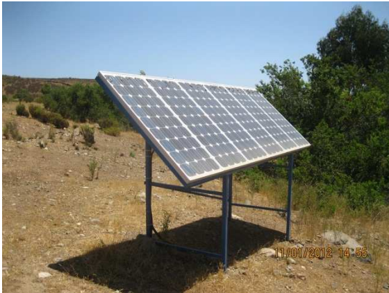
Generador compuesto por 6x75 Wp (=450 Wp) modulos ISOFOTON IS-15S/12
