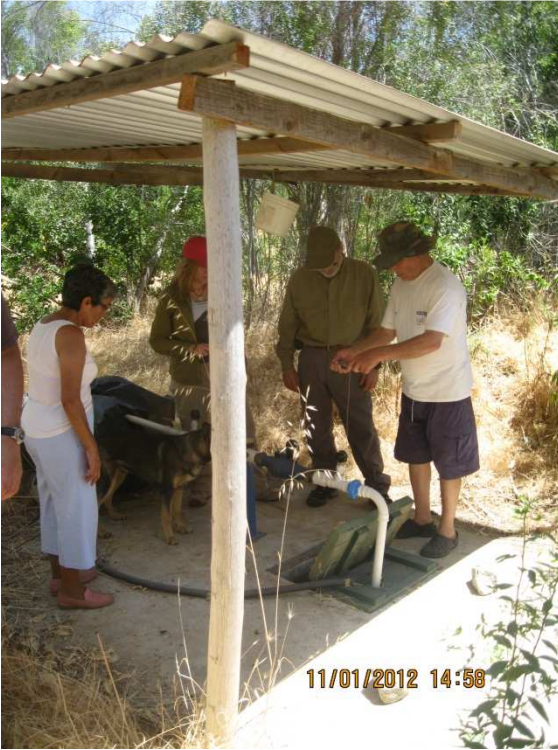
Vista del pozo y la tubería de conducción
