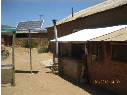
Módulo solar de 125 Wp.
