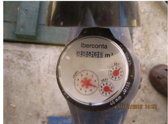
Contador de agua bombeada (acumulado 861 m3, promedio 0.79 m3/día durante 3 años)
