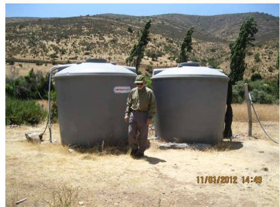
Tanques de almacenamiento 10 m 3 (2x5 m 3 )
